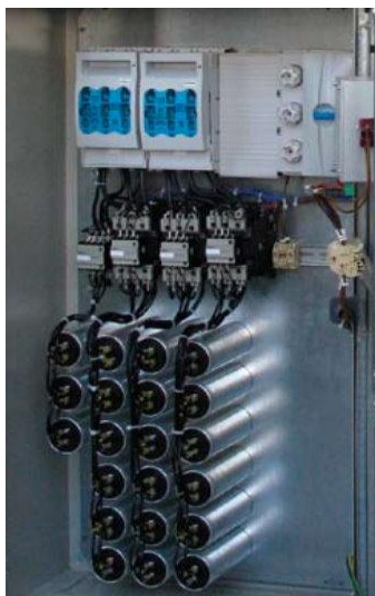
Slika 213: Kondenzatorji za kompenzacijo jalove energije
